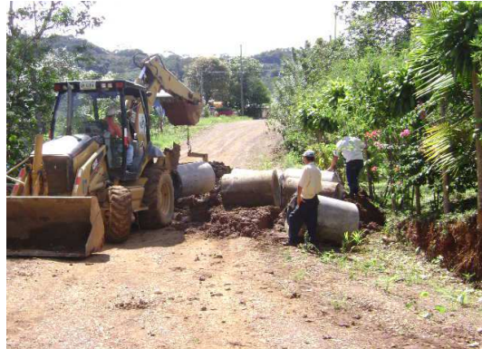
Alcantarillado San Rafael Platanares
