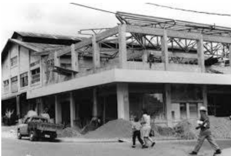
Ilustración 4: Edificio en construcción del Proyecto Biblioteca, Complejo y Museo Cultural de Pérez Zeledón.
