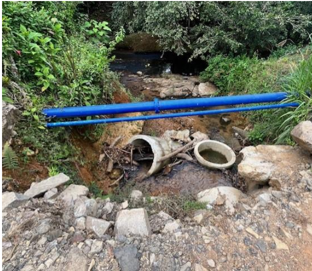
Fotografía 171. Afectación por Huracán Julia
