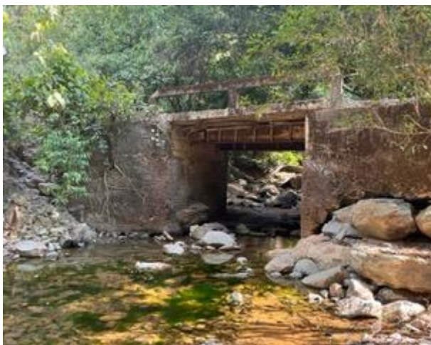
Fotografía 169. Afectación por Huracán Julia
