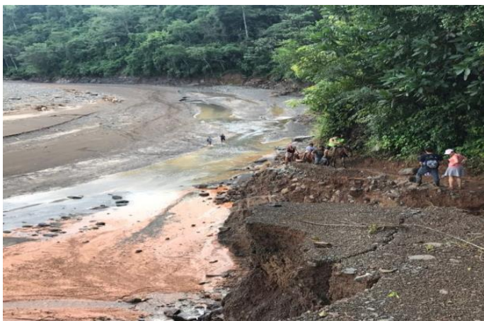
Fotografía 167. Afectación por Tormenta Nate
